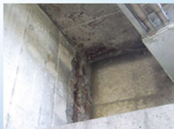
橋梁の漏水による破損例 (写真提供：函館開発建設部)
